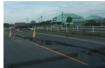
道路には亀裂が入り、交通網を寸断している
